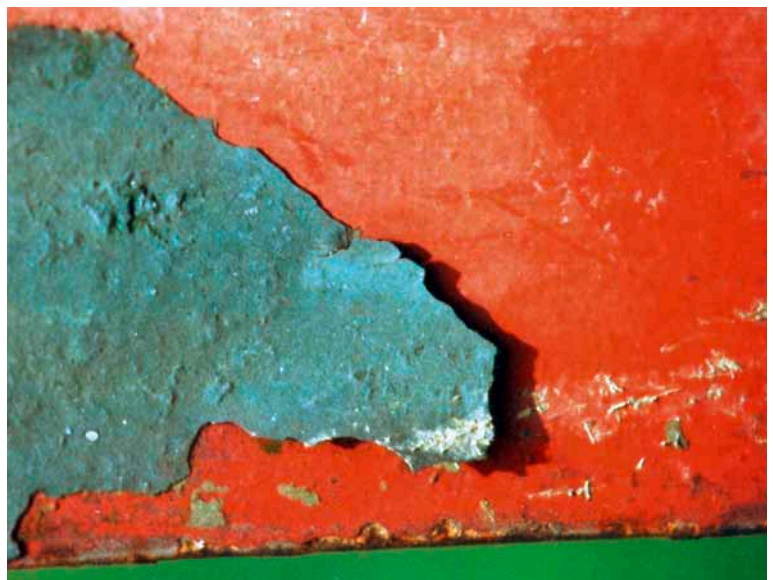
Couche de couverture délabrée par les éléments et révélant la couche de fond
