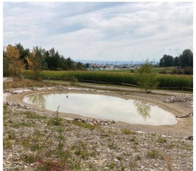
Einer der neuen Folien-Betonweiher etwas später im Jahr. Der Beton wurde zusätzlich mit einer dünnen Sandschicht überdeckt. Die Vegetation auf den Kiesflächen hat sich schon etwas entwickelt. (Foto: Alnus AG)
