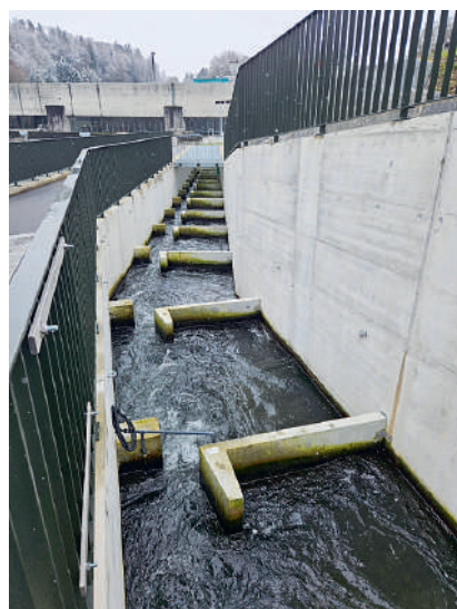
Fischaufstieg Typ Vertical Slot Pass in Betrieb im Kraftwerk Bannwil.
